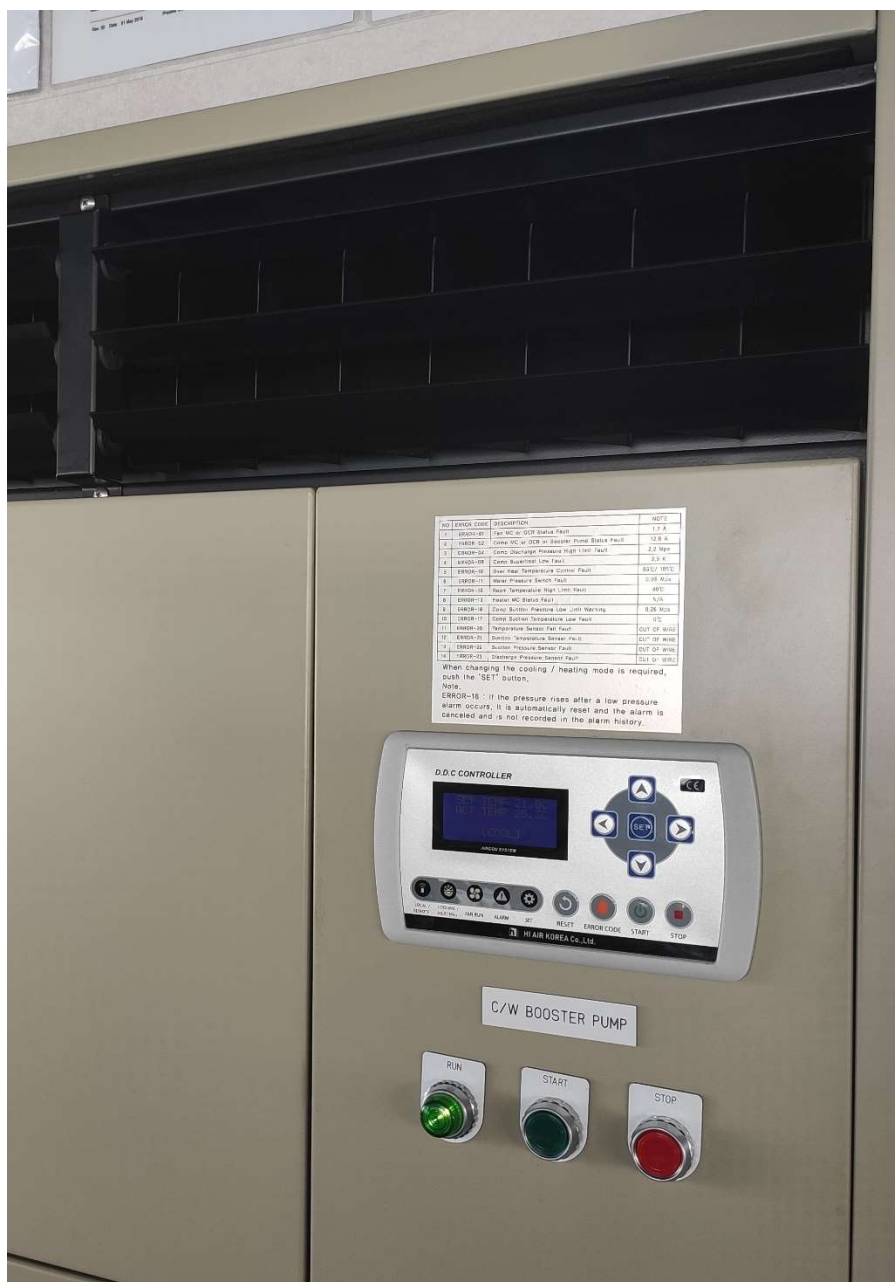
Rys. 5.8. Klimatyzacja na mostku z panelem do regulacji temperatury i wilgotności powietrza. Źródło: zdjęcie autorskie.
